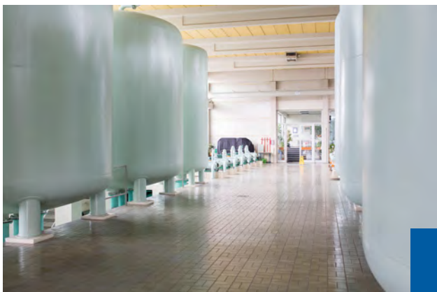
Filterreihe im Hemsbacher Wasserwerk
